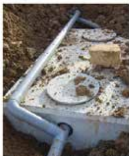
fosse toutes eaux
